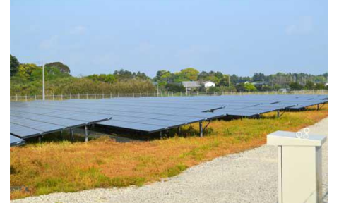
太陽光発電施設
